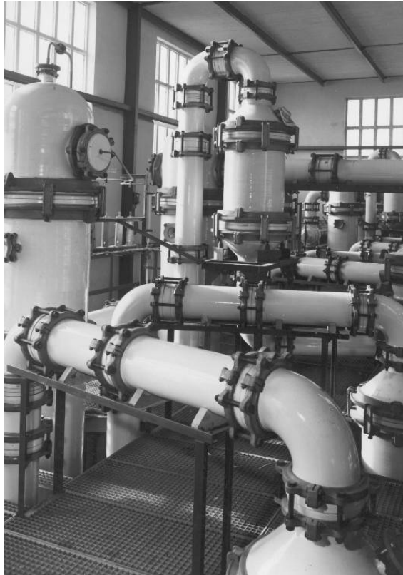
Bild 2: Vakuumkolonnen und Säureabscheider
