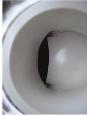
Bild 31: Kavitationsschäden in Kugelhahn DN50
