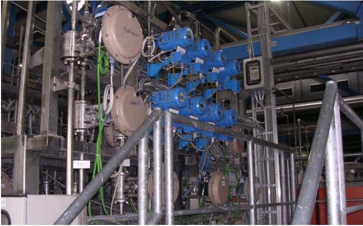
Bild 28: Teil einer automatischen Farbküche
