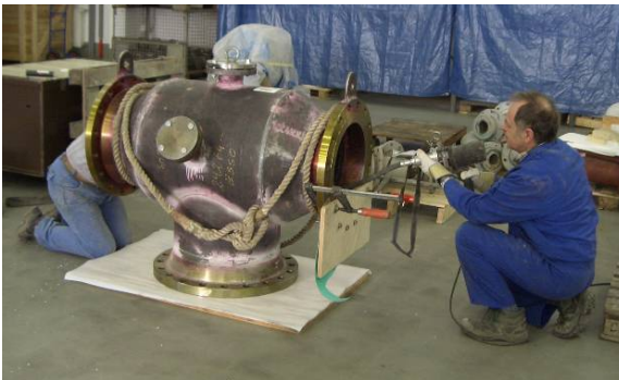
Bild 62: Mischventil bei der Auskleidung
