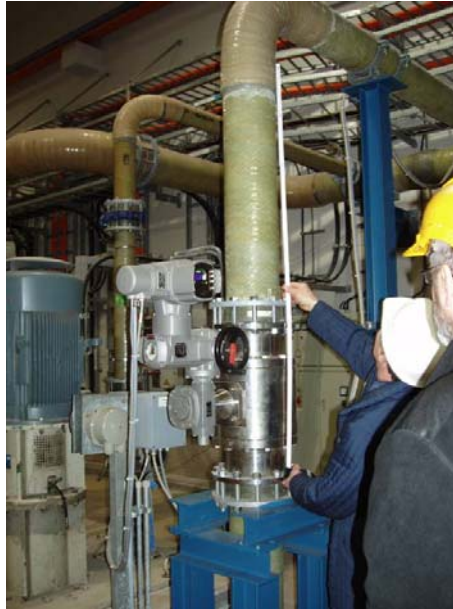
Bild 12: Prozesswasserstrecke im Kraftwerk
