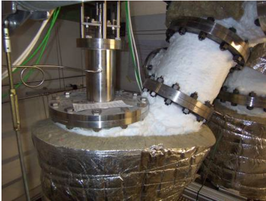
Bild 61: Hochtemperaturschieber 1.250°C nach Isolierung
